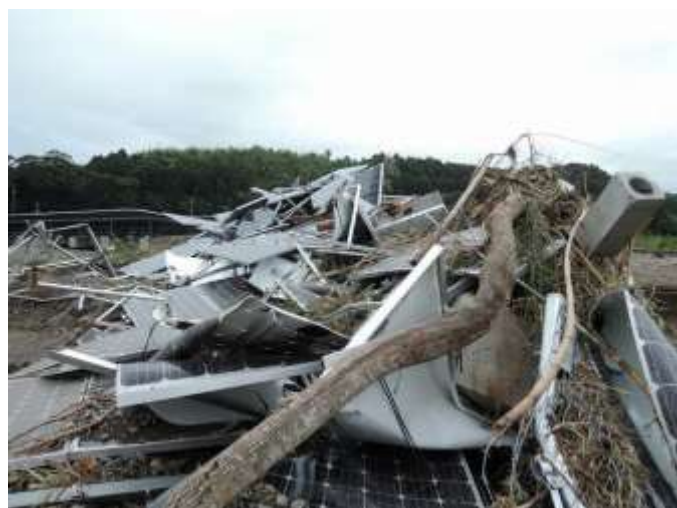
2015年、台風15号石垣島の太陽光パネルの損傷状況（石垣島、風速71m）
